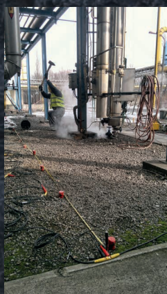
Tlenownia AirLiquide – badania sejsmiczne w rejonie zagrożonym osiadaniami
