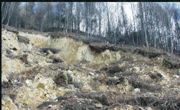
Zbocze ze znacznymi ruchami osuwiskowymi, u podnóża którego przebiega droga gminna.
